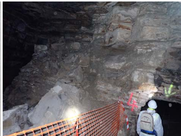
Figure 11 : Pilier partiellement effondré
