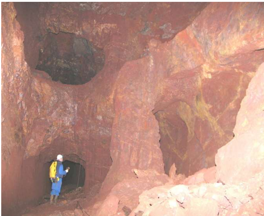
Figure 5 : surveillance par inspection visuelle des mines de fer de Normandie, risque d'effondrement sous habitations
