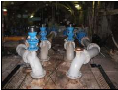
Fig. 9 : Station de pompage
